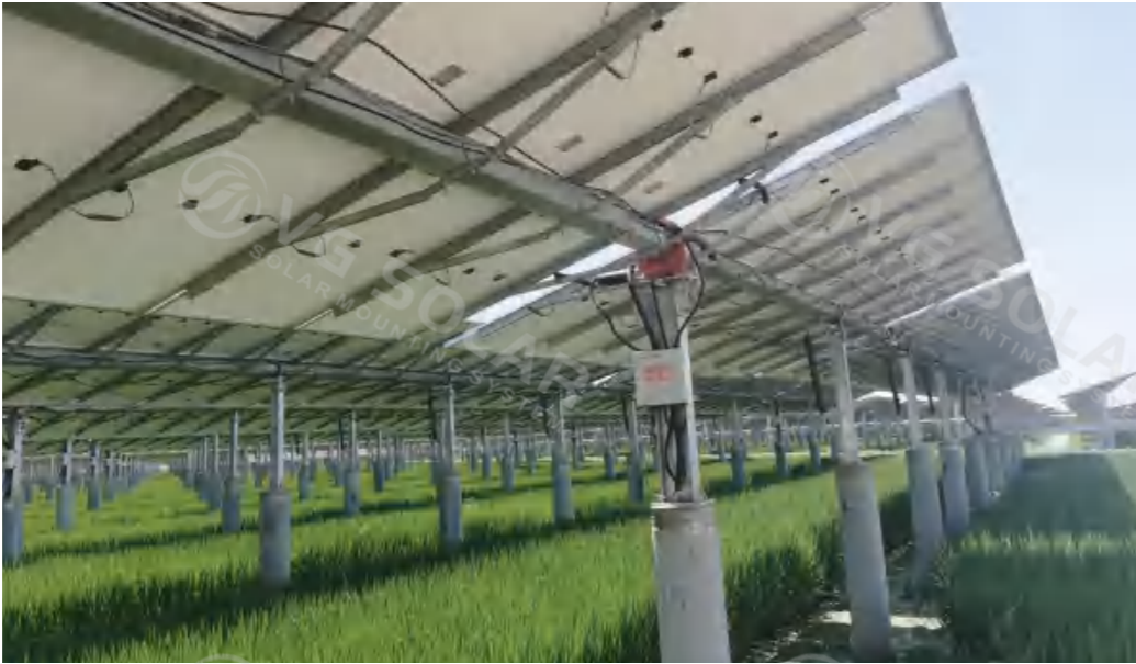
浙江温州150MW跟踪项目 150 MW - Zhejiang, China
