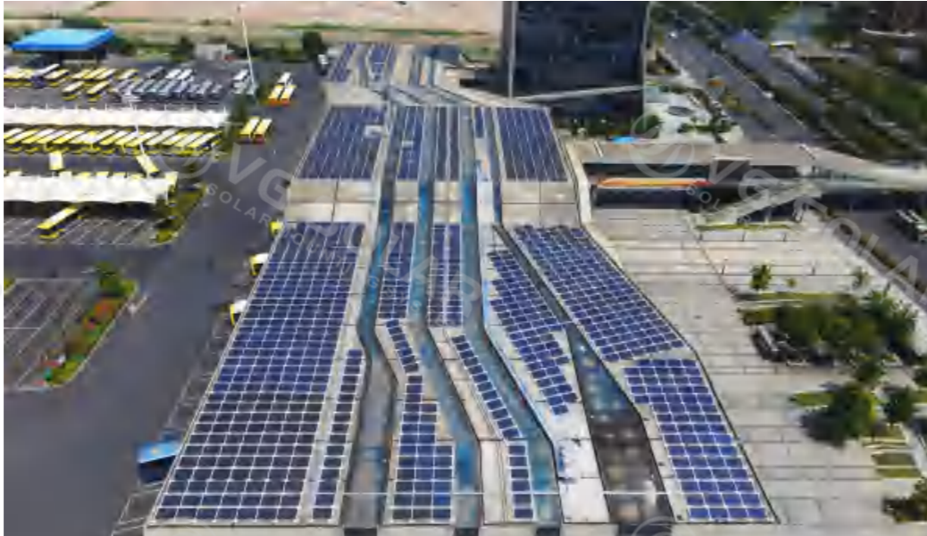
江苏无锡 3.5MW 3.5 MW - Jiangsu,China
