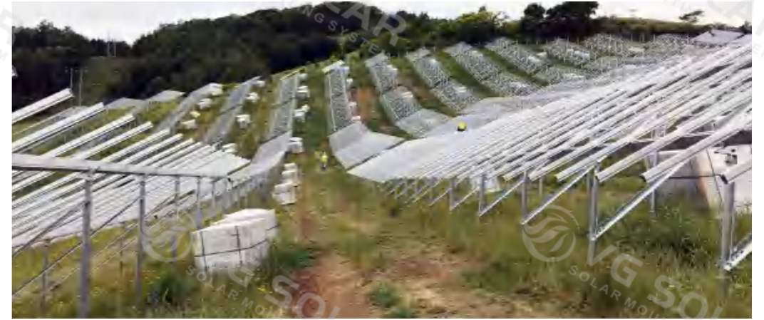
日本北海道 13MW 13 MW - Hokkaidō,Japan
