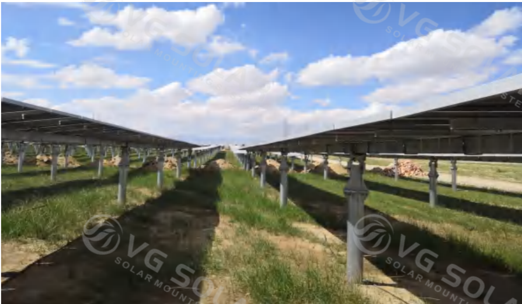
江苏丹阳180MW跟踪项目 180 MW - Jiangsu, China
